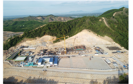
越南顺化光大富山垃圾发电项目
