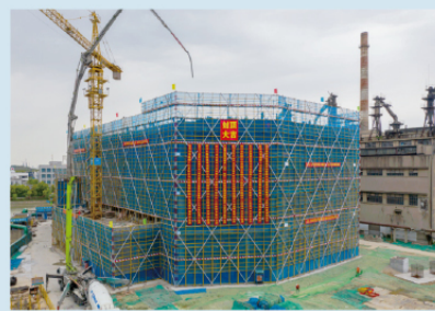
数据中心机房项目
